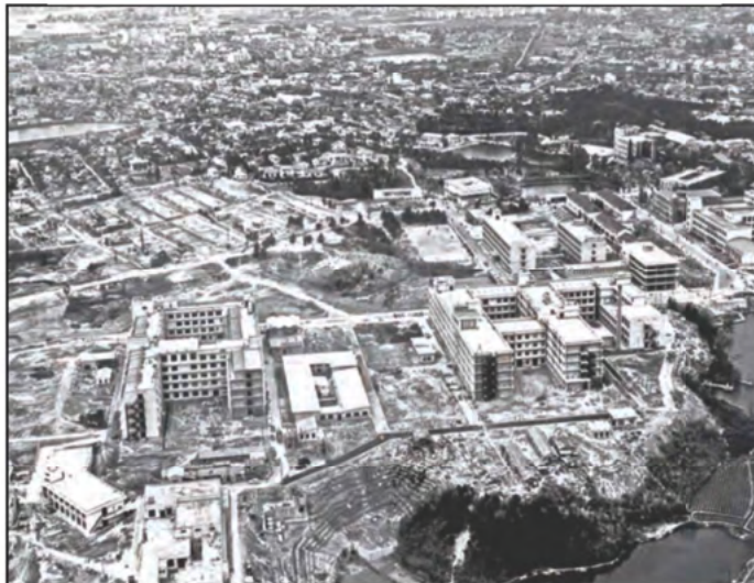
昭和39年(1964)基礎工学部と理学部が建設中の豊中キャンパス (弓場 宏さん提供)
